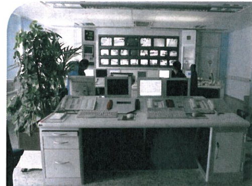
Centre de contrôle d'un important site industriel, entièrement géré par le logiciel Security M@nager
